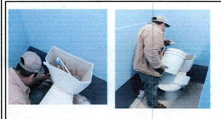
FOTO 9: SERVICIOS SANITARIOS Y ACCESORIOS
